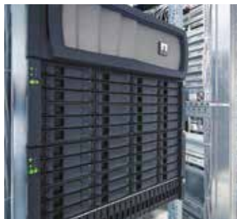
Centros de telecomunicações
